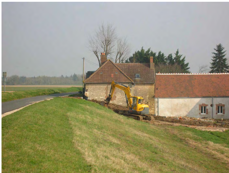
Figure 5-45. Travaux (non autorisés) dans le remblai d'une digue, réalisés par les habitants d'un bâtiment encastré dans celle-ci (Source : R. Tourment).
