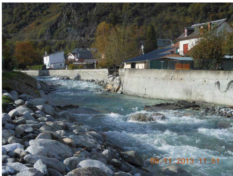
Figure 2-10. Effondrement partiel de la digue en béton en rive gauche du Gave de Cauterets à Souлом (65) à la suite du sous-cavage de sa fondation (Source : D. Sabatier, ONF - RTM 65 - novembre 2013).
