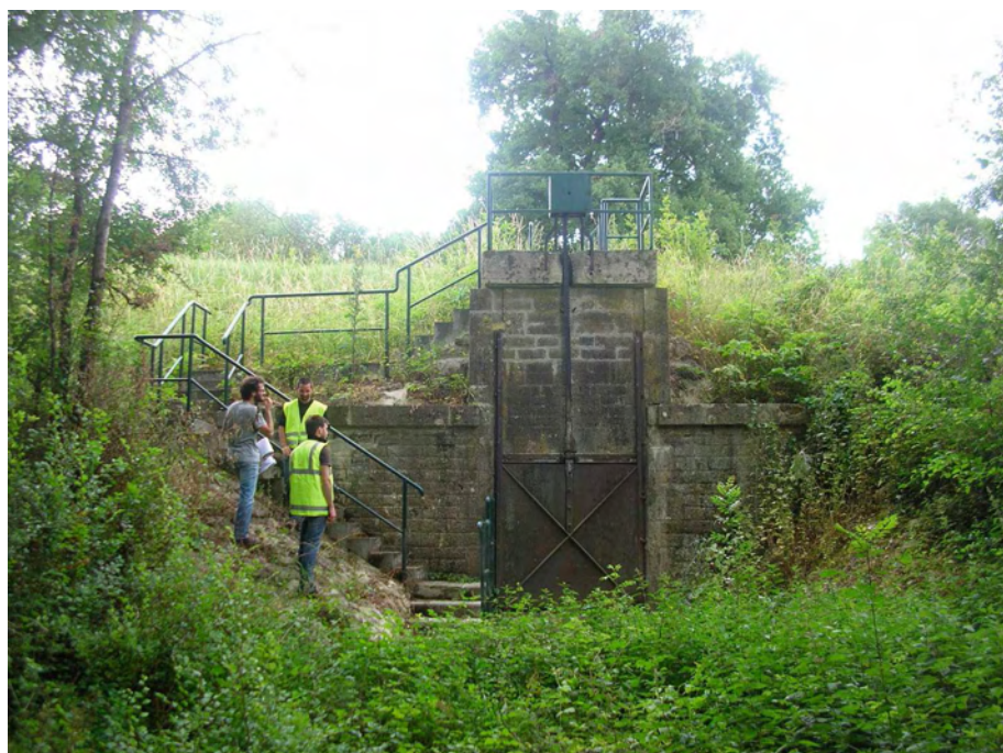
Figure 2-92. Pertuis vanné d'un exutoire de drainage de la zone protégée sous une digue (Source : R. Tourment).
