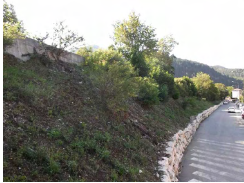
Figure 2-33. Lit perché - digue du ravin de la Recluse (Castellane, 04) (Source : J.-C. Pin, ONF - RTM 04)
