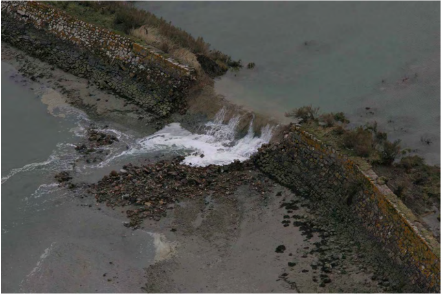
Figure 5-65. Brèche partielle sur une digue littorale, le 3 mars 2010, après la tempête Xynthia du 28 février 2010 (Source : DREAL Pays-de-la-Loire).
