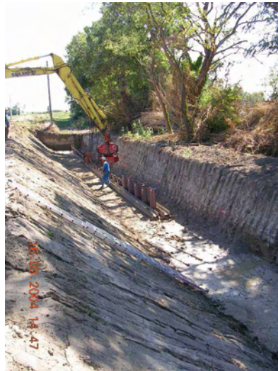
Figure 2-76. Pose d'une étanchéité de fondation par palplanche (Source : R. Tourment). Le remblai étanche sera ultérieurement posé et compacté au-dessus (Petit Rhône à Albaron).
