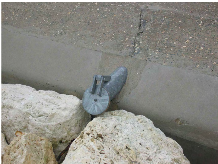
Figure 2-93. Clapet en aval (côté eau) d'une canalisation d'évacuation des eaux pluviales de la zone protégée (Source : R. Tourment).
