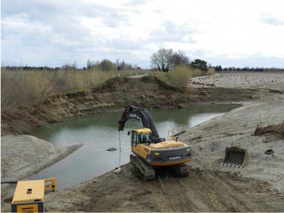
Figure 5-66. Brèche et fosse d'érosion sur une digue de l'Agly en 2013 (Source : P. Mériaux)
