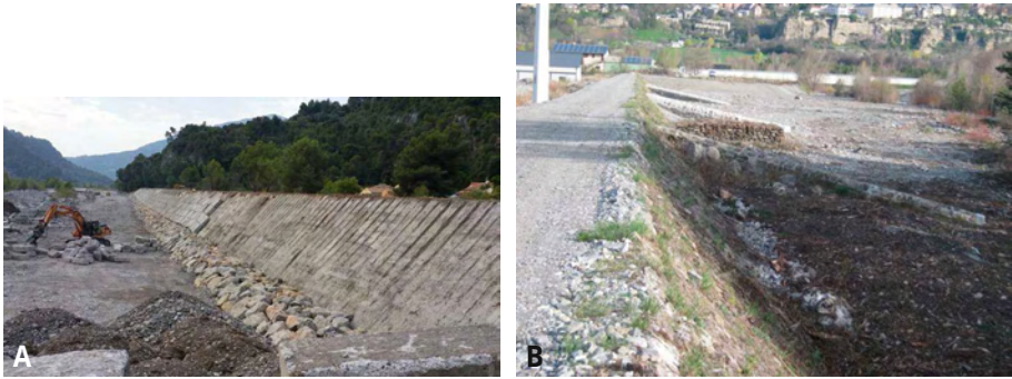
Figure 2-106. Exemples d'ouvrages parafoUILLES associés (Source : ONF – RTM).
