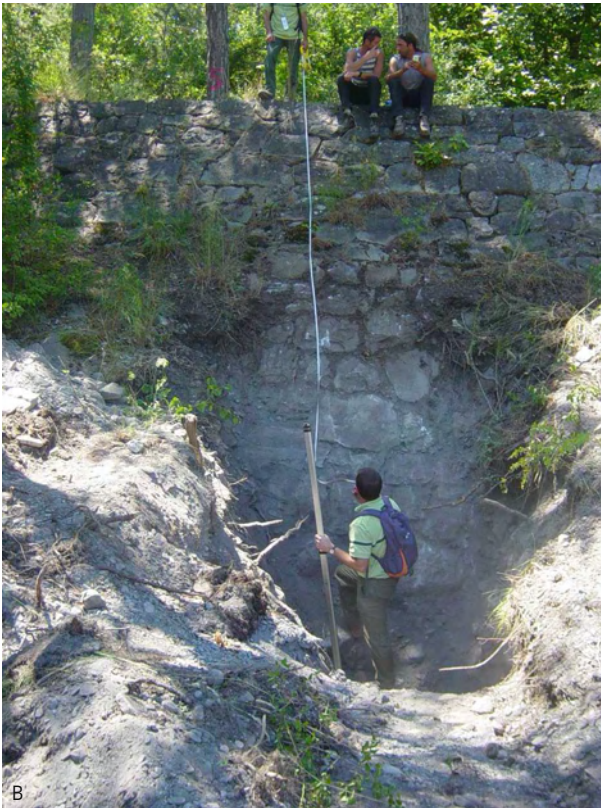
Figure 2-103. Coupe-type des travaux d'endiguement du Vachères (1841) (A) et contrôle des fondations (2012) (B) (Source : ONF – RTM 05).
