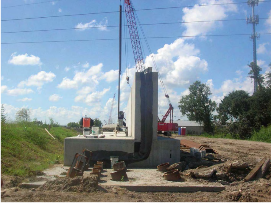
Figure 2-83. Rehausse par mur en T en cours de construction (Source : R. Tourment). Noter l'étanchéité par palplanches et les extrémités des pieux de fondation sur la dalle support au premier plan.
