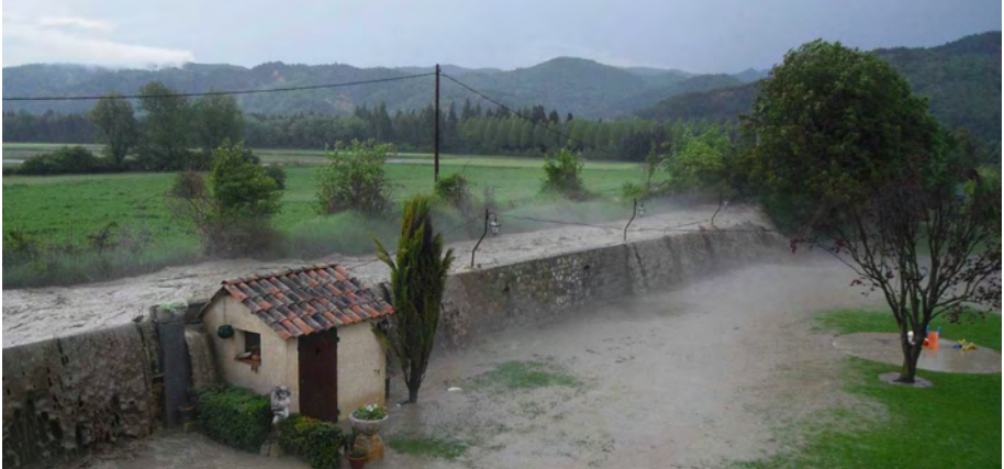
Figure 5-62. Surverse sur la digue du ravin du Ponteillard à Mallemoisson (04) : section entre la route nationale et la Bléone – Crue du 22 mai 2012 (Source : M. Mandine, fonds ONF – RTM 04).
