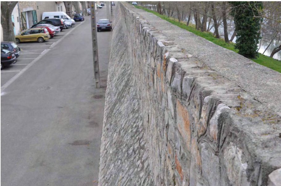
Figure 2-79. Digue poids en maçonnerie protégeant le village de Comps (30) des crues du Gardon et de celles du Rhône par remous (Source : R. Tourment).
