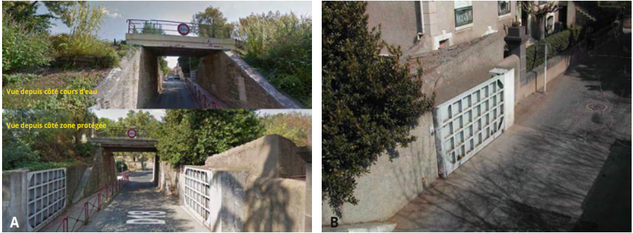
Figure 2-96. Passage inférieur dans le remblai ferroviaire de Saint-Thibery (34) équipé d'une double porte anti-crues (Sources : A) Google Street View ; B) P. Ledoux, CEREMA)
